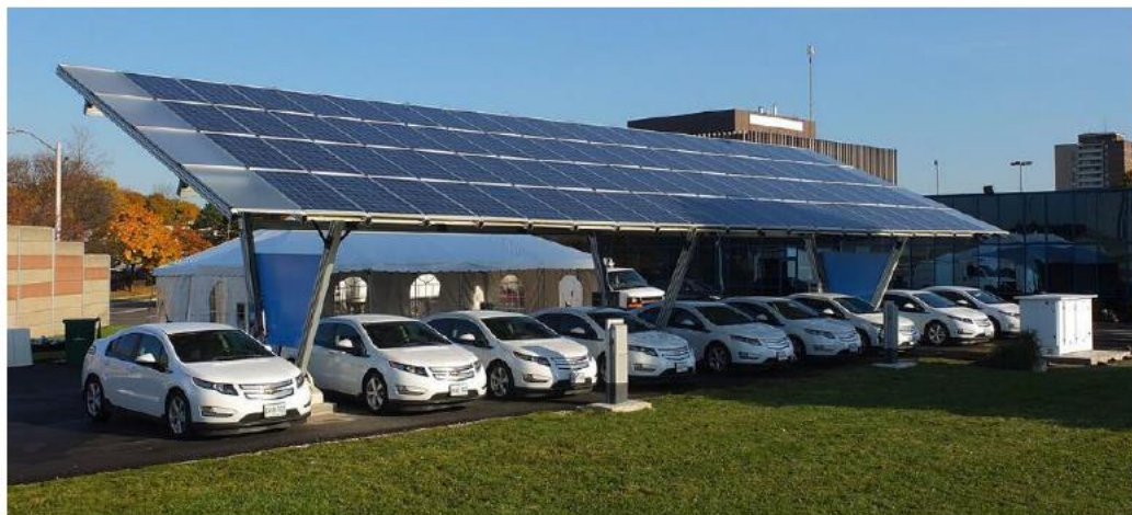
2-сурет. Электромобильдерге арналған күн зарядтау станциясы
